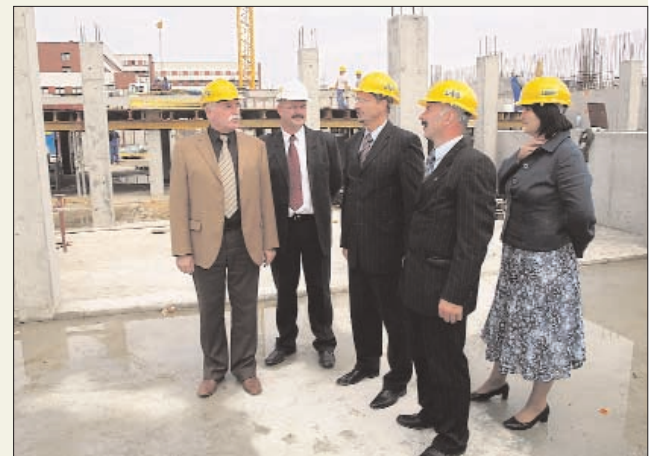
Zarząd Powiatu na bieżąco zapoznaje się z przebiegiem prac przy budowie kościerskiego basenu. Na zdj. od lewej: wicestarosta Grzegorz Cyrzan, sekretarz powiatu i jednocześnie pełnomocnik ds. realizacji inwestycji Grzegorz Zabrocki, starosta Wiesław Baryła, członkowie Zarządu Czesław Cyra i Alicja Kirstein." FOT. TOMASZ SZALA
