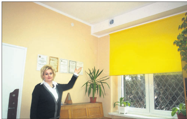
Wentylacja mechaniczna z efektem odzysku ciepła została zainstalowana we wszystkich pomieszczeniach Szkoły Muzycznej w Kościerzynie. Na zdj. Katarzyna Karczewska, dyrektor szkoły.
